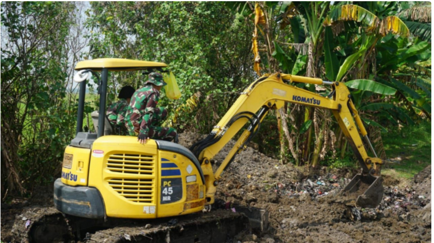
Kodim 0716/Demak Menurunkan Alat Berat Exavator Untuk Membangunkan Bak Sampah Warga Di Lokasi TMMD
